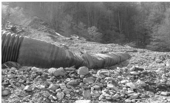
Рис. 2. При сходе селевого потока в апреле 2012 г. по одному из ручьев (левый приток р. Мзымта) была уничтожена гофрированная труба противоселевой галереи (Фото Ю.В. Ефремова)
