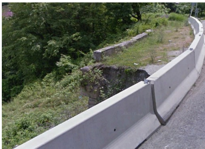
Рисунок 2 — Стенка срыва грунта на исследуемом участке дороги
