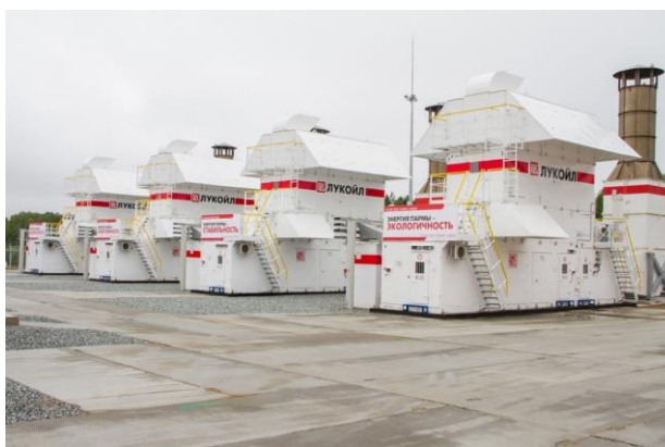
Рисунок 2 – Газотурбинная электростанция в Пермском крае, позволяющая обеспечить утилизацию ПНГ
